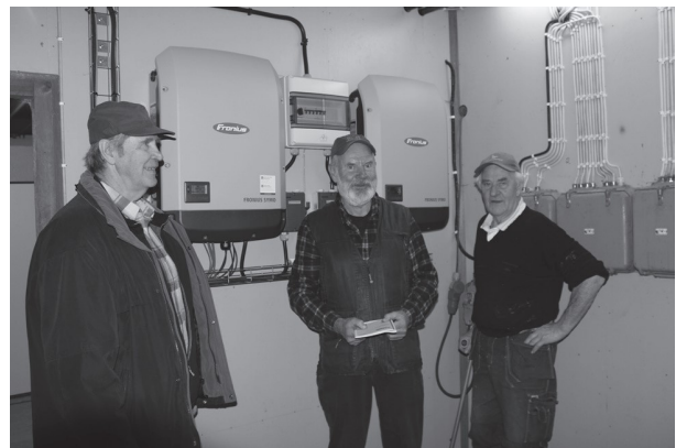
Lars-Åke visar de avancerade styrskåpen till solcellsanläggningen
